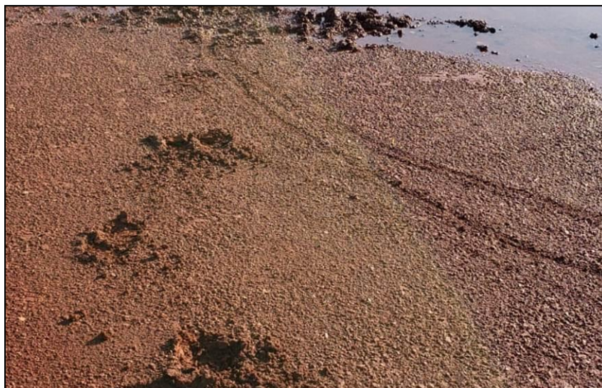
Figura 4 : Imagem mostrando a camada superficial solta devendo ser escarificada.
