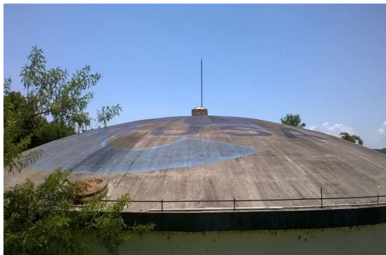
Figura 7: Imagem do reservatório externo necessitando uma nova pintura externa.
