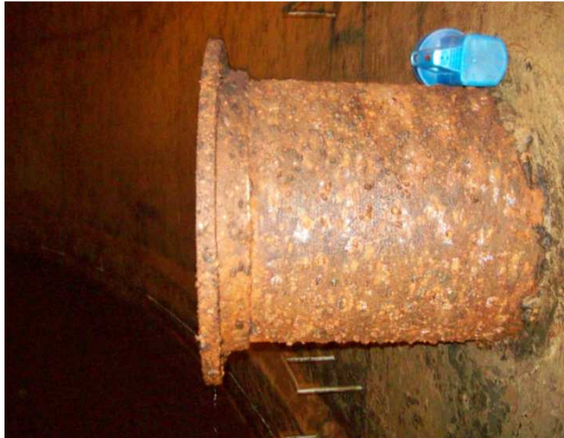
Figura 5: Tubulação de entrada do reservatório com o corpo necessitando proteção mecânica para proteção do meio agressivo.
