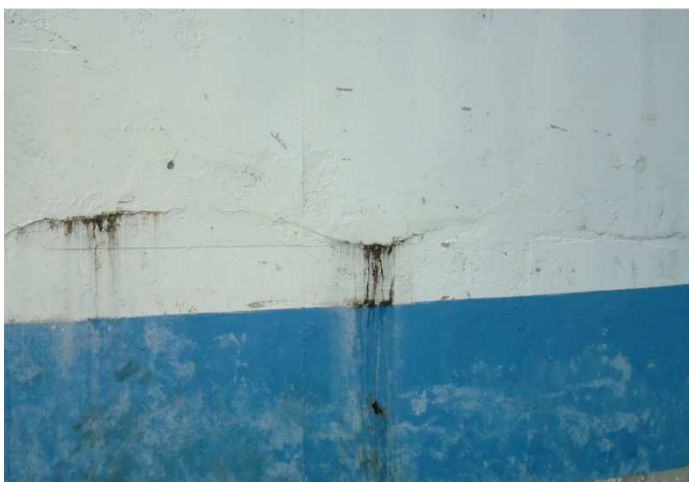
Figura 3: Junta de concretagem com pontos de vazamento.
