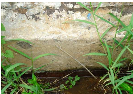
Figura 12: Vazamento na junta de dilatação encontrada no reservatório Maurício Cardoso.
