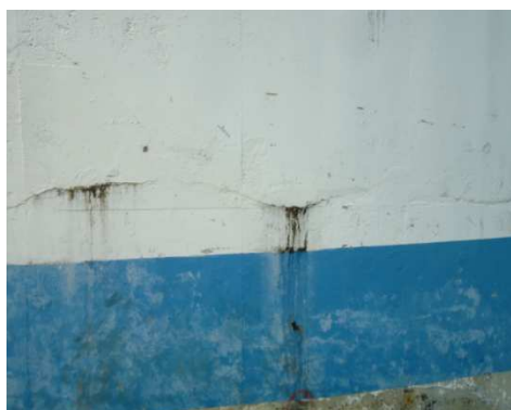
Figura 16: Junta de concretagem que necessita reparo.
