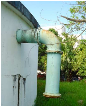
Figura 2: Tubulação do extravasor do reservatório.
