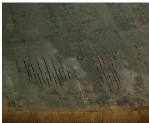
Figura 11: Fase crítica de corrosão havendo comprometimento sério das armaduras.
