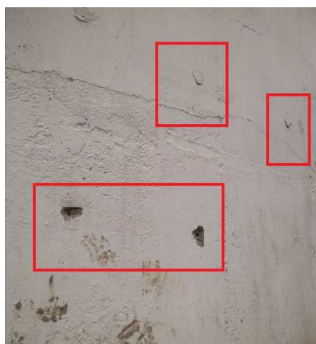
Figura 20: Pontos onde houve deslocamento e pontos com preenchimento de vazios durante a construção do reservatório apresentando deslocamento.
