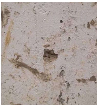
Figura 19: Deslocamento do concreto em virtude de corrosão localizada da armadura.
