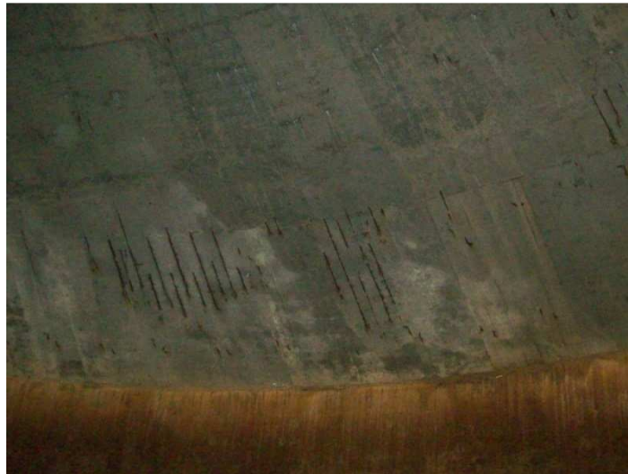
Figura 6: Outra foto da cúpula do reservatório com armaduras expostas e cujo recobrimento de proteção não existe mais.
