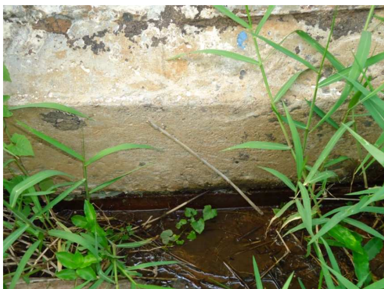
Figura 4: Junta de dilatação com vazamentos significativos em pontos isolados.
