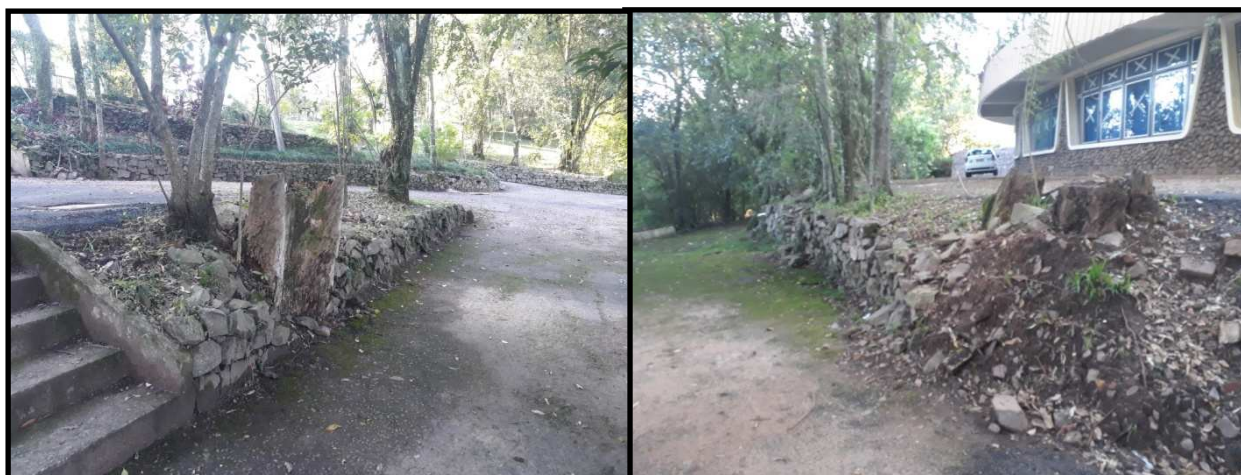
Foto 10 | Trechos danificados dos muros de pedra na região do antigo Restaurante
