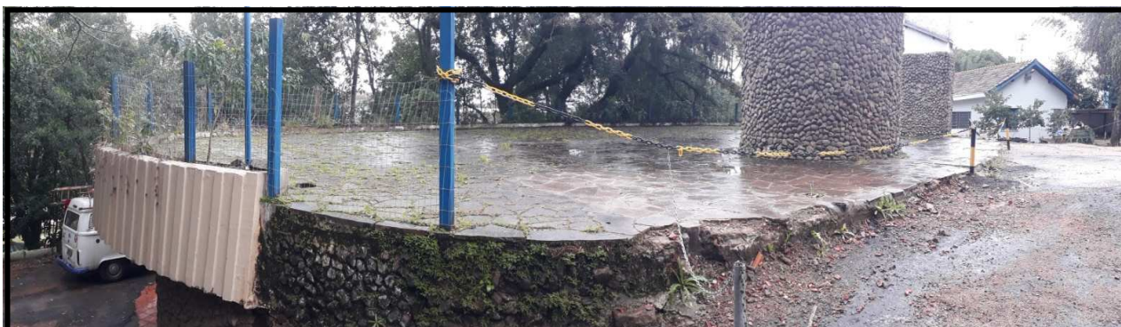
Foto 12 | Tela de proteção, no perímetro da laje do antigo Restaurante , que será substituída
