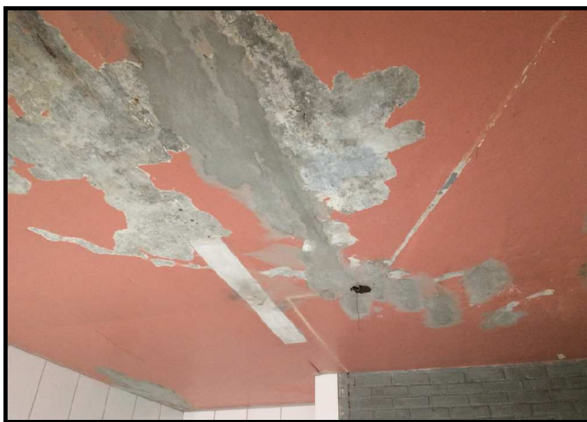
Foto 1 | Reparos na pintura de teto, devido à umidade vinda da parte superior da laje |Socioambiental
