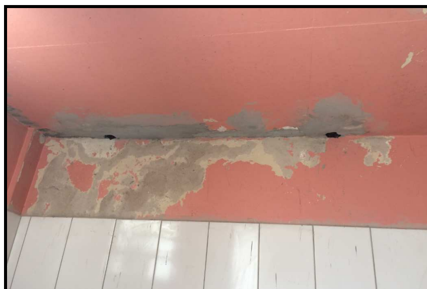
Foto 2 | Área que teve bolor (mofo) retirado, causado pela permeabilidade da laje |Socioambiental
