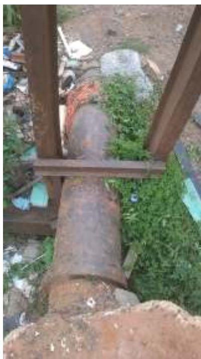
Figura 3 – Foto da adutora na margem da Avenida 14 Bis
